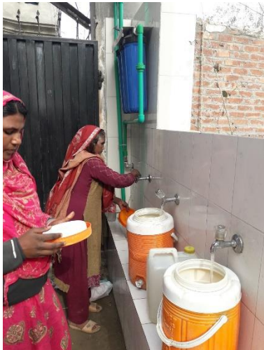
Afbeelding 3.1.3 Waterpomp in Khaliq Nagar
